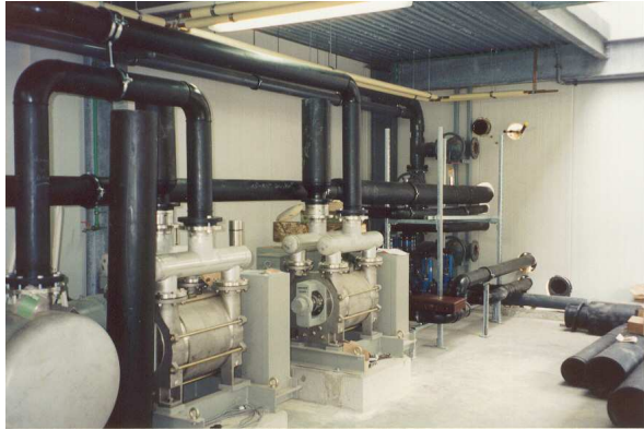
Kompressoren zum Rauchgaseintrag
