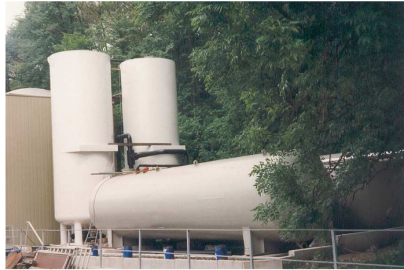
Blasensäulenreaktoren und liegende Abwasserspeicherbehälter
