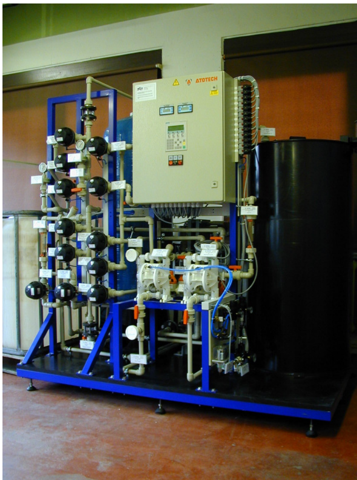
Ansicht einer Ionenaustauscheranlage mit HCl-Tank im Hintergrund
