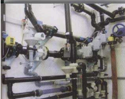
Abb. 2 Bedienarmaturen der Ionenaustauschanlage für Luft-/Wasserspülung und Probenahme
