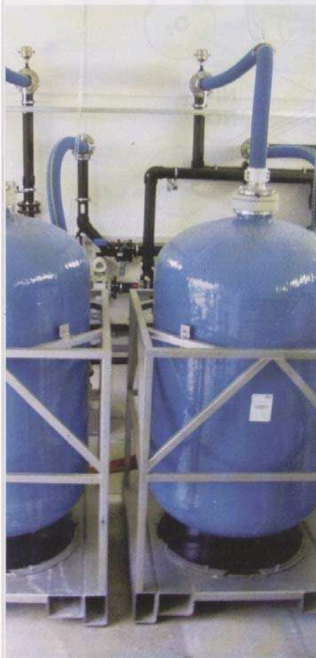
Abb. 1 Ionenaustauscheranlage zur Nickelentfernung aus ca. 80.000 m 3 Trinkwasser pro Jahr
